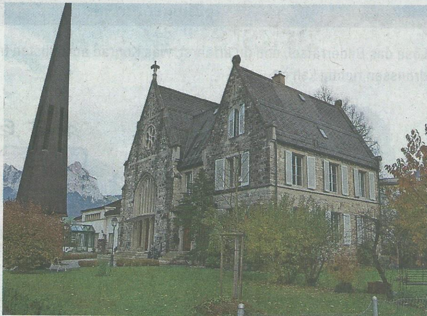
Eine Untersuchung hat gezeigt: Das Dach von Kirche und vom Pfarrhaus in Brunnen muss mittelfristig saniert werden.
